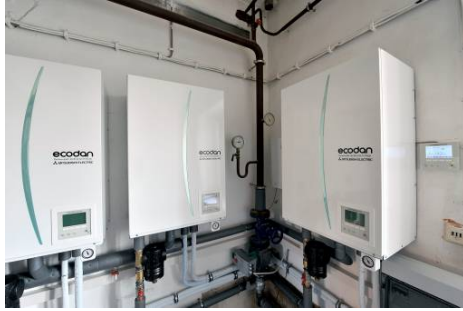
[2688] Die platzsparenden Hydroboxen wurden in einem Nebenraum der Garage des Wohnhauses installiert.
